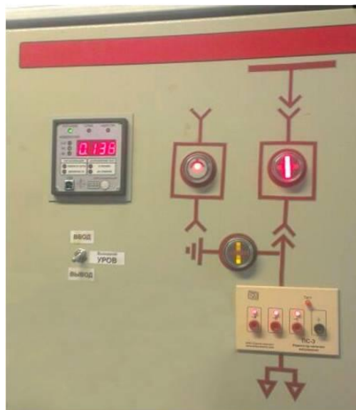
Рисунок 4.3 – Устройство TOP 110-ИЗН, установленное в ячейке 19 на ПС «Олимпийская» в г. Волгограде
